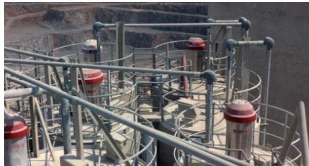
Siloentstaubung mit dem PNEUFIX und dem FLOW-BOW®
